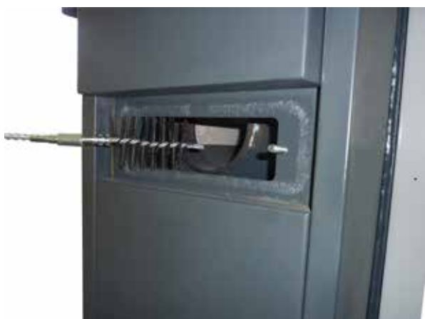
Nettoyage de la partie centrale de la tuyauterie des fumées - couvercle central
