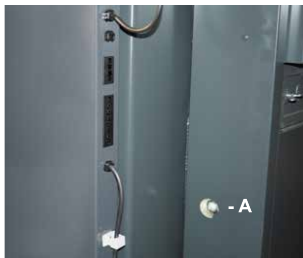
A - ouverture pour mesurer la teneur réelle en O 2 (excès) lors du chauffage avec des pellets
