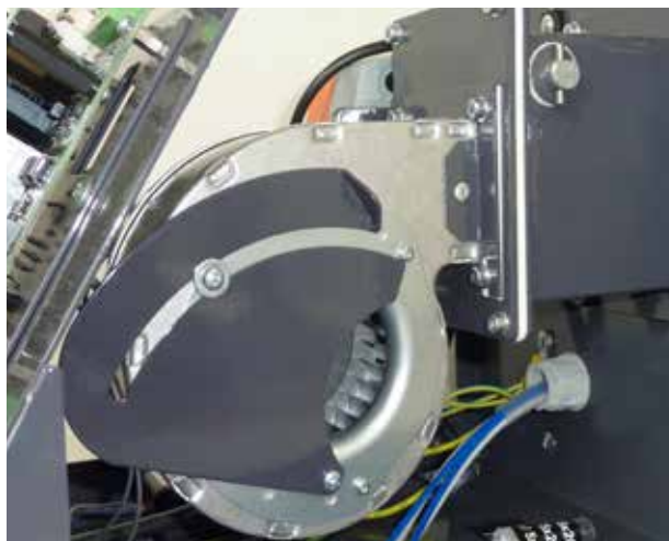
Ventilateur du brûleur et son clapet à air. En ouvrant le clapet, vous réduirez la longueur de la flamme.
