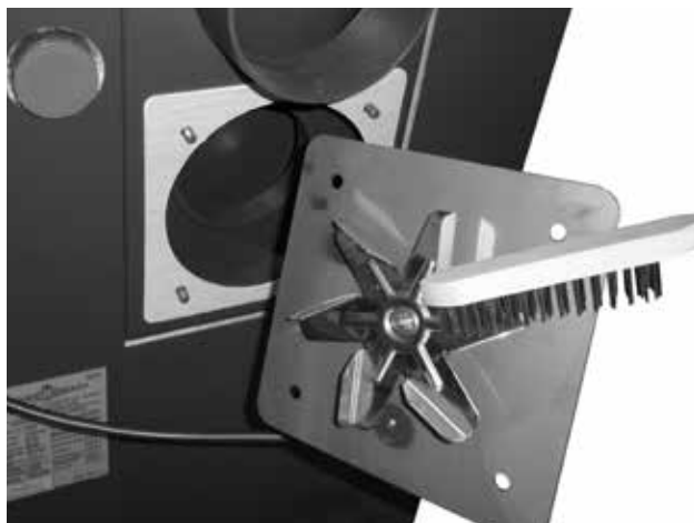
Nettoyage de la roue mobile et contrôle de la perpendicularité des pales du ventilateur de tirage (à l'exception D10PX)
