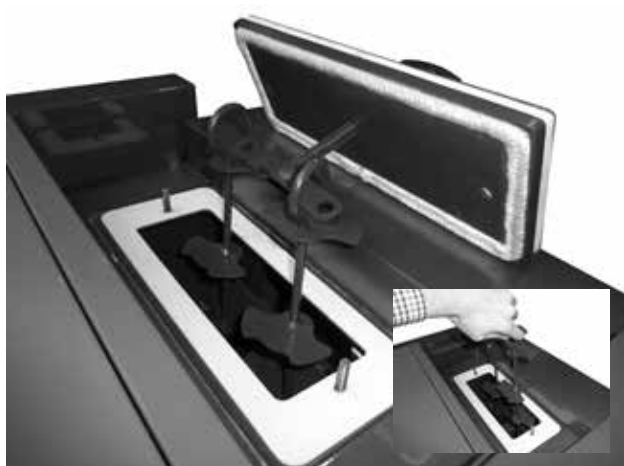
Exemple pour retirer des turbulateurs de l'échangeur tubulaire avant nettoyage cleaning
